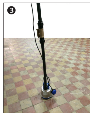
3 Pumpinredning monterad och klar.
