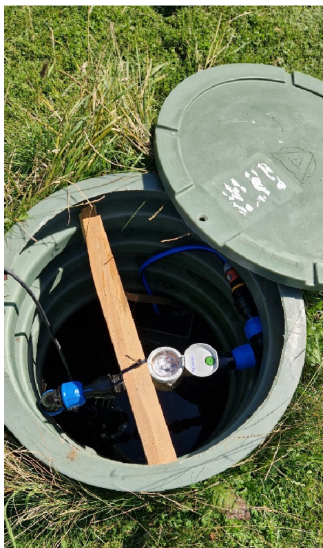
Figur 8. Mosjö-Råby 1:18, 29 juli 2024. Pump och vattenmätare monterades i befintlig fosforfälla.
