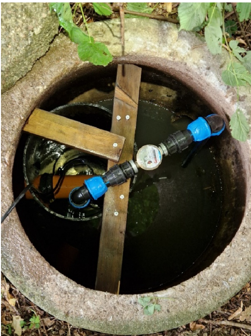
Figur 12. Vara-Västerbitterna 1:8, 13 augusti 2024. Utloppsbrunn monterad i befintlig brunn av betong.
