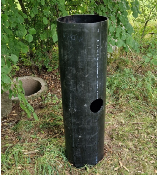
Figur 11. Vara-Västerbitterna 1:8, 13 augusti 2024. Pumpbrunn av PE i dimension 400.
