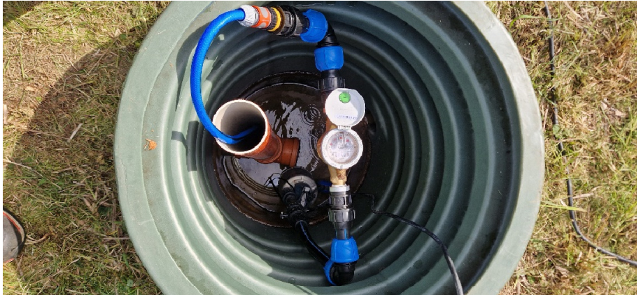
Figur 10. Lossby 3:3, 13 augusti 2024. Vattenlås och pump monterat i befintlig utloppsbrunn.
